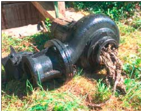
Regenbecken Wigart: Putzfäden und Putzlappen haben die Pumpe blockiert.
