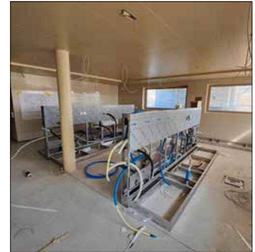
Die Küche mit den Installationswänden für die Haustechnik.
