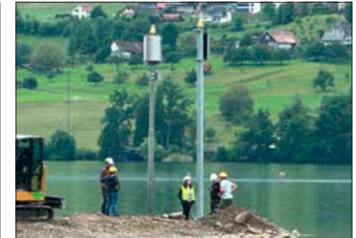
Die alte Leuchte (links) wird durch die neue ersetzt (Bild: Ueli Haller).
