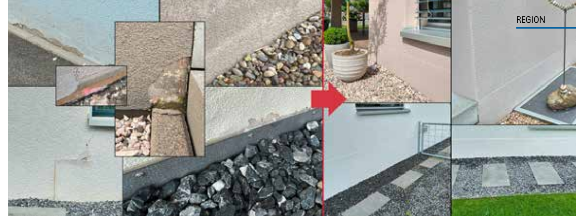
Ein frühzeitiges Reagieren und Handeln bei Schäden an Fassadensockeln erspart eine grössere Sanierung der ganzen Fassade.
