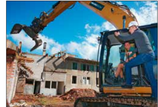
Gerne an auch der Front: Christian Schweizer begleitet den Abbruch der Altliegenschaft an der Risistrasse.
