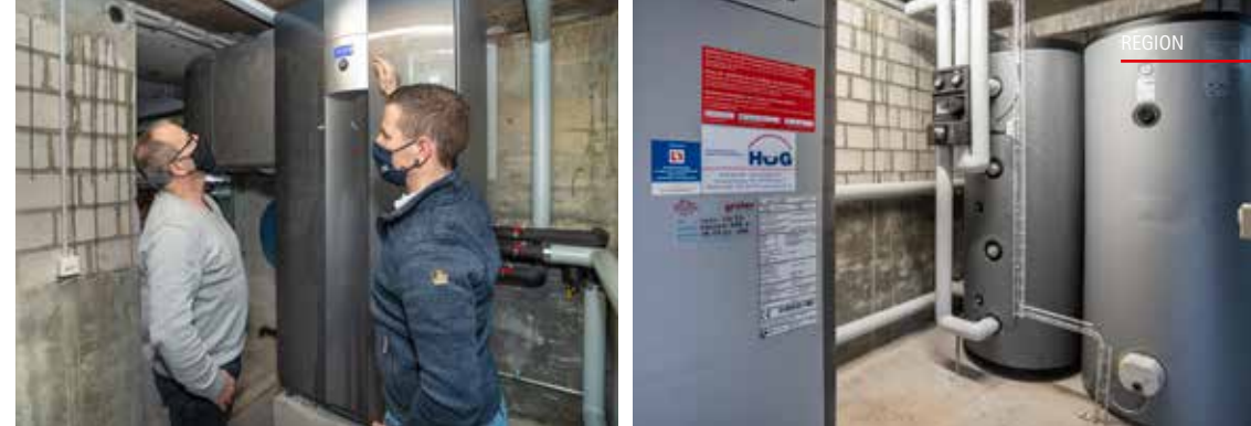
Livio Käser (rechts) erklärt Julius Giger die neue Wärmepumpe. Rechts sind Heizungsspeicher und Wassererwärmer zu sehen.
