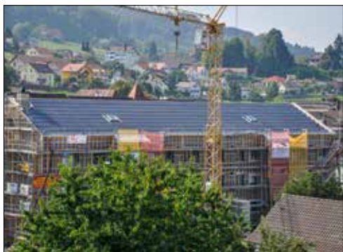
Photovoltaikanlage bei einem MFH in Menziken.
