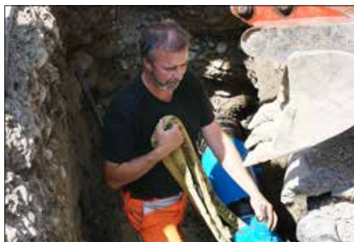
Im Graben: Alex Siegrist beim Montieren eines neuen Wasserschiebers an der Ermelgasse.
