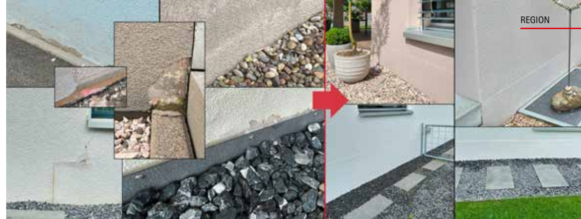
Ein frühzeitiges Reagieren und Handeln bei Schäden an Fassadensockeln erspart eine grössere Sanierung der ganzen Fassade.
